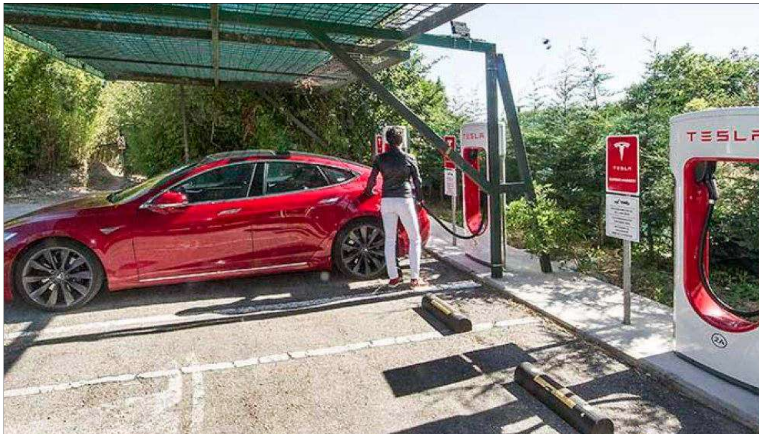
Una conductora recarga la batería de su Tesla Model S en el supercargador instalado en el Hotel Landa. I. L.M
